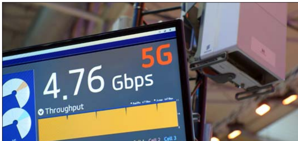
Eine Sendeanlage für den schnellen 5G-Datenfunk. Die IHK sorgt sich, dass der Main-Kinzig-Kreis nicht flächendeckend mit dem neuen Mobilfunk-Standard versorgt werden könnte. • Foto: dpa
