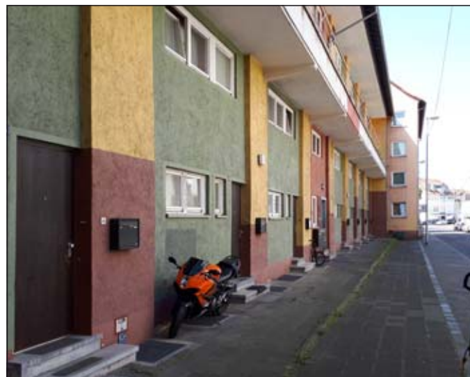
Die maroden Häuser in der Hahnenstraße stehen mittlerweile weitgehend leer.
